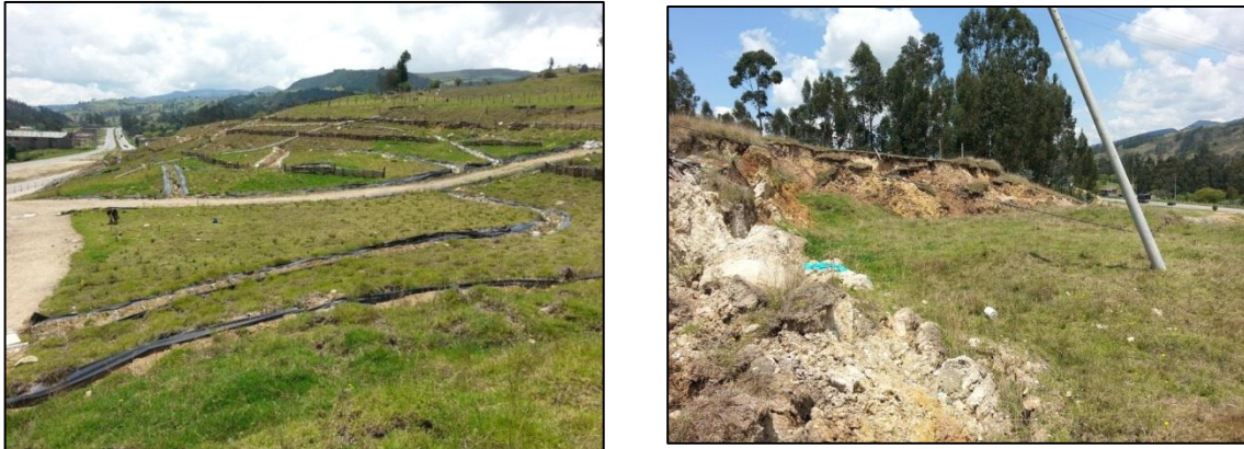
Figura 31. Sitio N° 2. a) Vista general del deslizamiento y b) Vista del deslizamiento huésped localizado en la parte sur.
