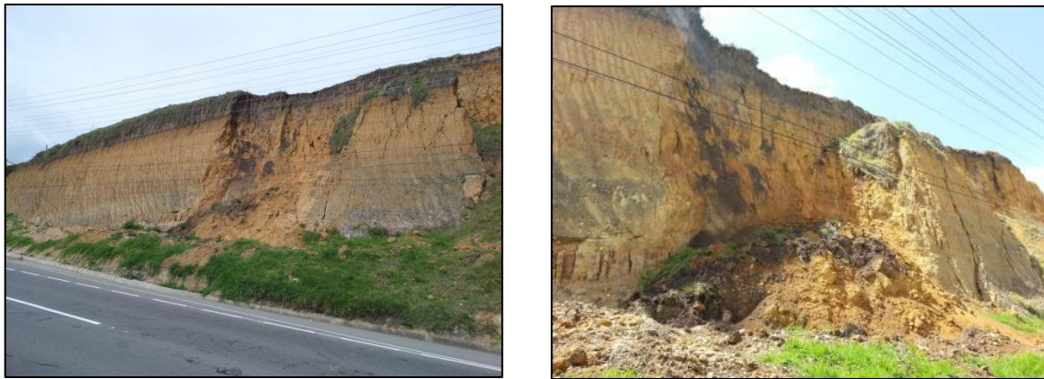
Figura 24. Sitio N° 1. a) Vista general del talud y b) Detalle mecanismo de falla por volteo en IGMs.
