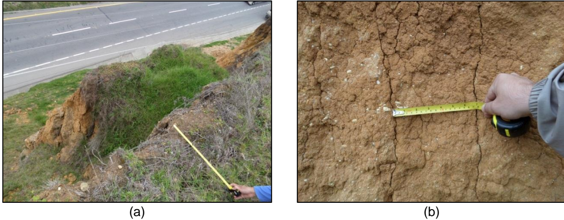
Figura 30. a) Medición de la separación de las fisuras en la corona de los taludes, las cuales corresponden a los bloques fallados y que están próximos a desprenderse y b) Medición de la separación de las fisuras en la superficie del talud.
