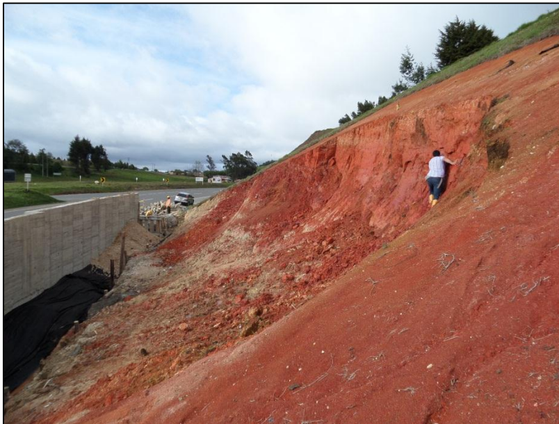
Figura 35. Detalle de la superficie de ruptura del deslizamiento rotacional del sitio N°3
